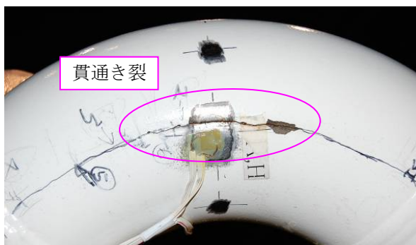
(b) エルボ 3 側部の軸方向の貫通き裂
